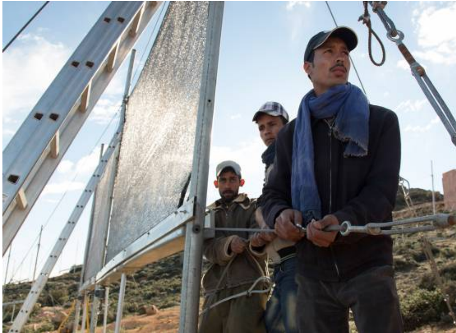
Instalación de las mallas en un terreno montañoso para suministrar agua a las poblaciones bereberes. / Dar Si Hmad
