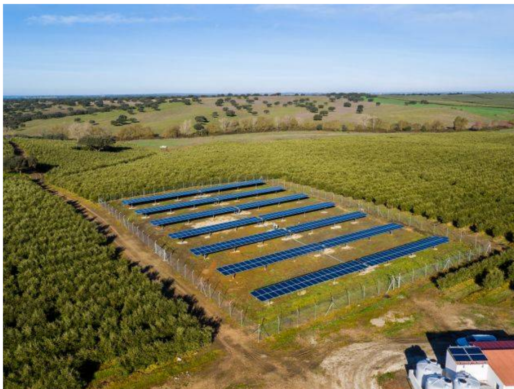
Riego fotovoltaico de 140 kWp en Alter do Chao (Portugal). / MASLOWATEN
